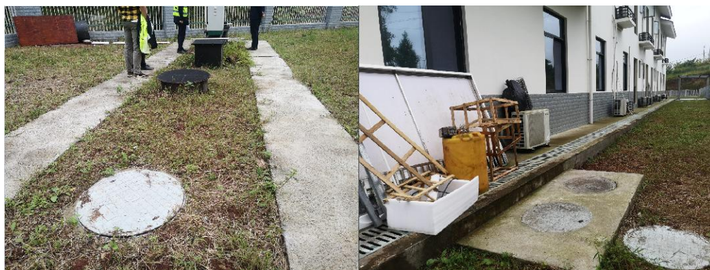
图 7.1-1 收费站管理房污水处理设施照片
